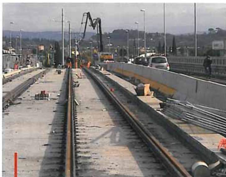
Il cantiere nel quale è impegnata l'impresa Grazzini comprende il Viadotto Moro e V.le Nenni, uno dei siti più impegnativi.
